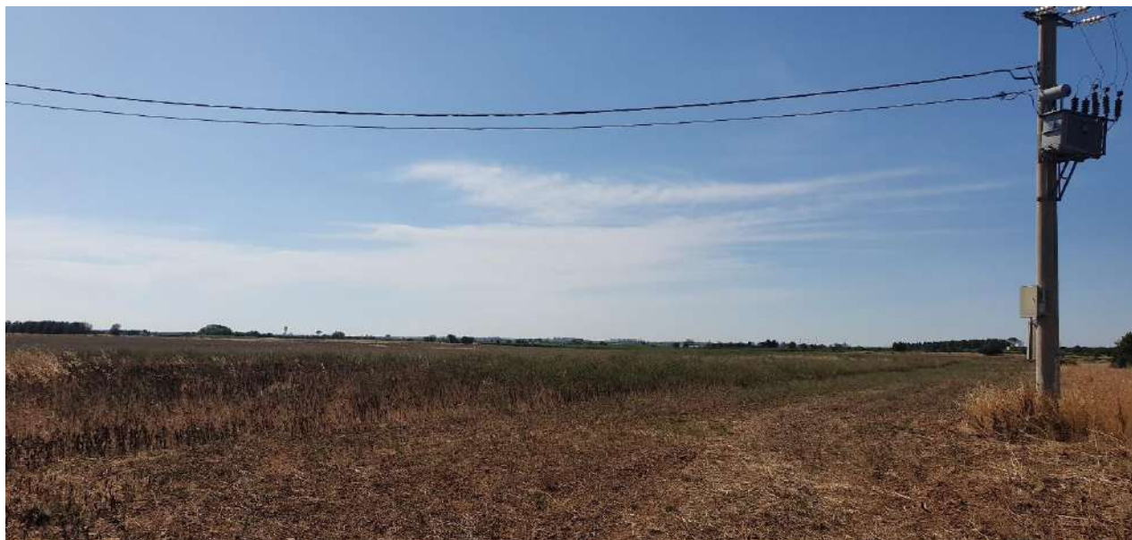
Figura 30: Vista in direzione della SSU-BESS
