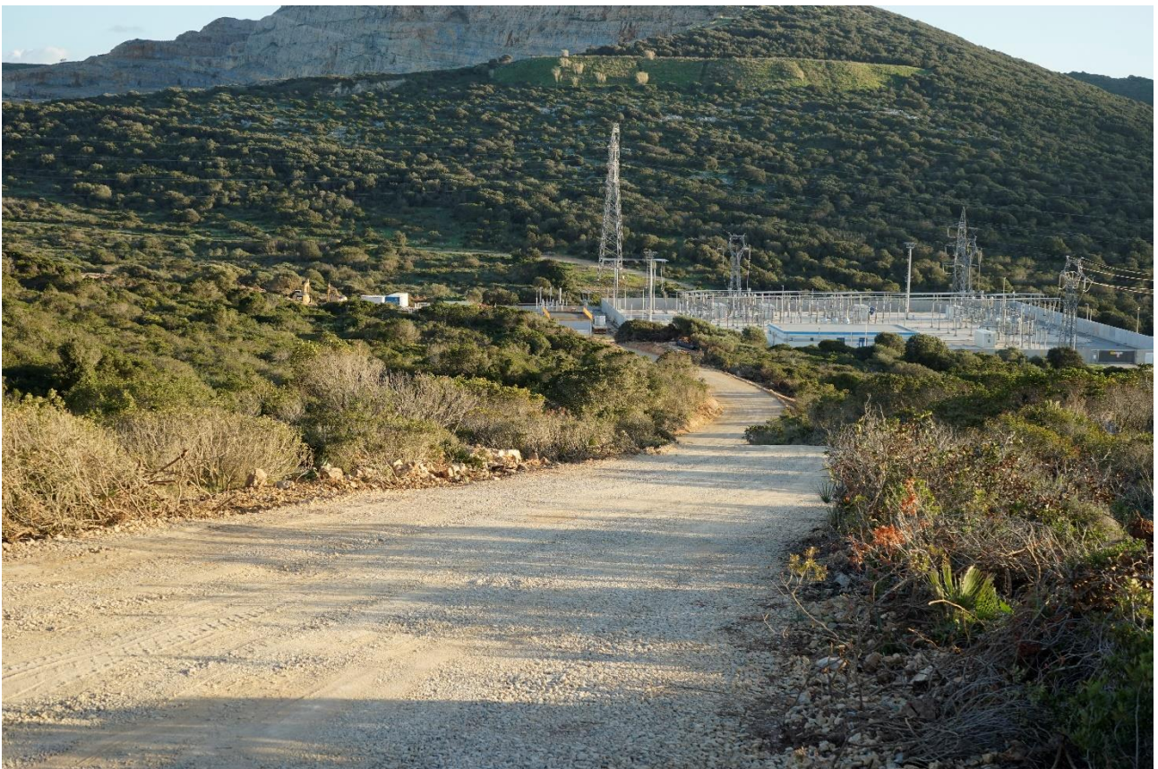
Figura 3- Stazione RTN "Porto Torres 2" e Stazione di Utenza dell'impianto eolico Wood Sardegna in fase di costruzione
