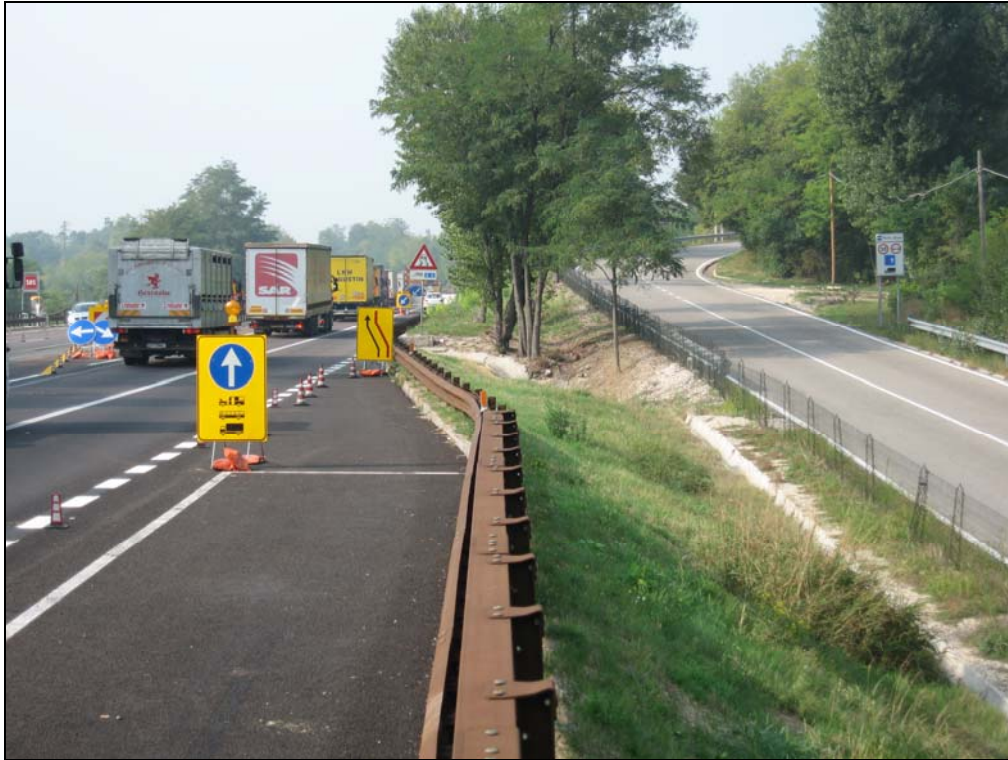
FOTO 3: Particolare delle canalette di raccolta delle acque meteoriche in corrispondenza dei tratti in rilevato
