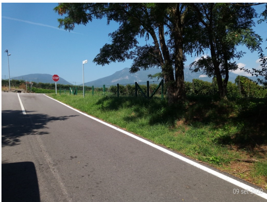
Fig. 27. Limite settentrionale di via del Castello, tratto a ovest del SVP 68 (parte occidentale). Si nota, oltre la vegetazione, il dislivello rispetto al terreno retrostante
