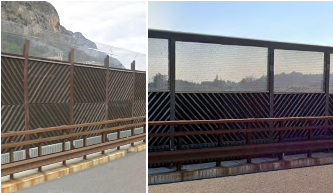
Figura 40: Pannelli tipo di legno, con rigature oblique e parti trasparenti in PMMA, già posati rispettivamente in corrispondenza dell'abitato di Canale e presso il sovrappasso S.P. 31 in loc. Ronchi, circa 3,5 km a sud di Cavaion Veronese, e simili a quelli proposti nel presente progetto
