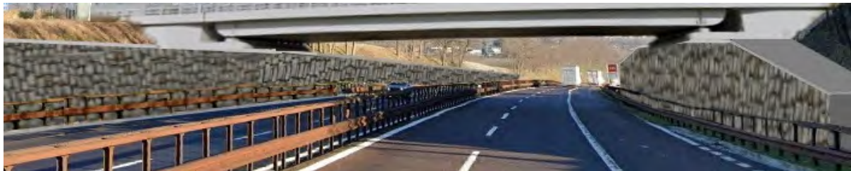
Figura 46: Rivestimento delle spalle di uno dei sovrappassi, in continuità con i muri di controripa prima e dopo il sovrappasso su ambo i lati (dettaglio dal fotoinserto del nuovo sovrappasso n. 69).
