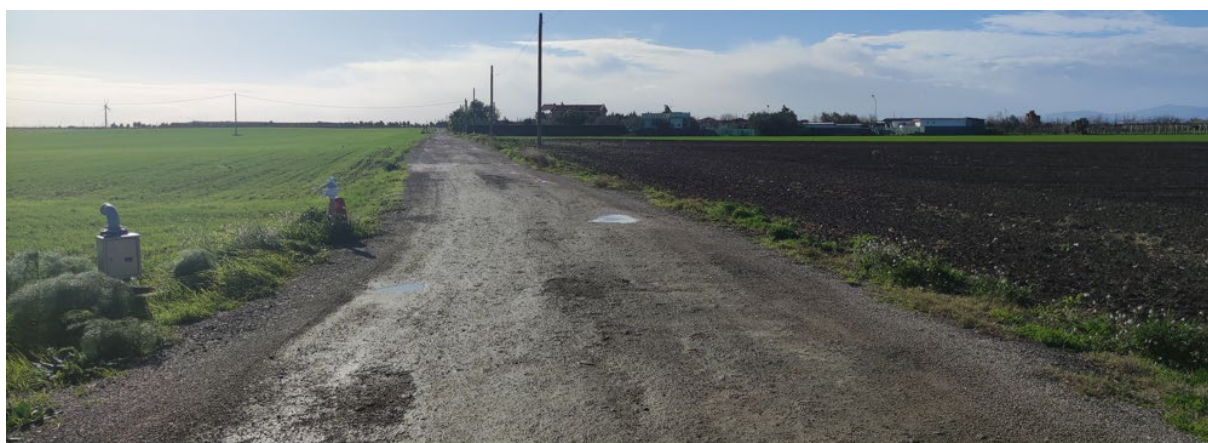
Viabilità in conglomerato bituminoso esistente in pessimo stato
