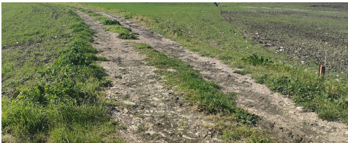
Viabilità esistente con pavimentazione naturale in pessimo stato
