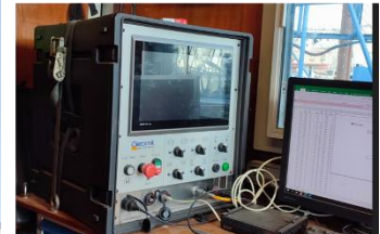
SISTEMA DI CONTROLLO E ACQUISIZIONE DATI
