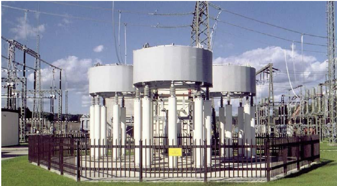
Figura 36 - shunt capacity reactor - fonte Siemens
