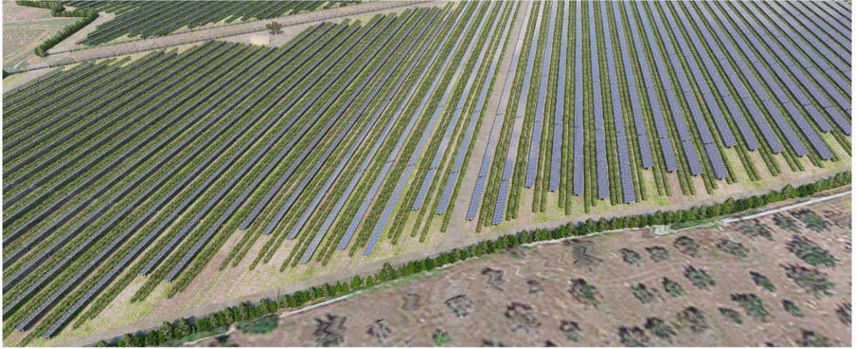
Figura 2 – Porzione area impianto post operam
