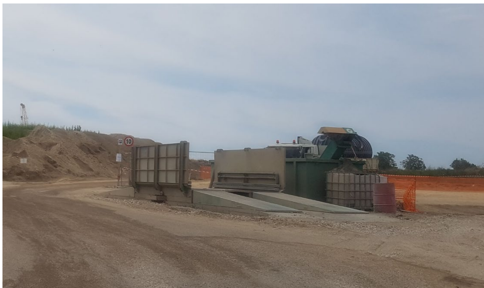
Figura 48 Esempio di impianto automatico lavaggio ruote mezzi d'opera
