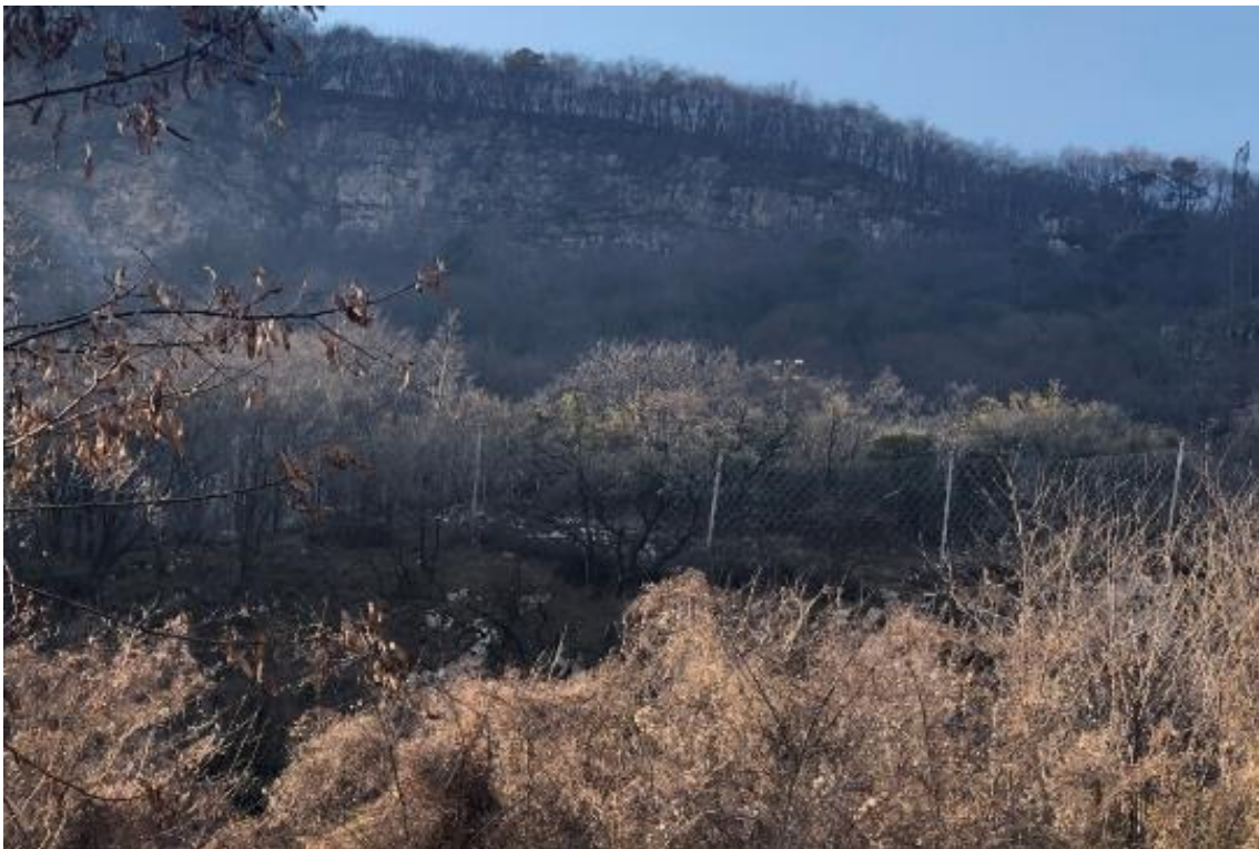
Fig. 31 - Reti paramassi a protezione dai crolli e rotolamento massi dalle falesie rocciose
