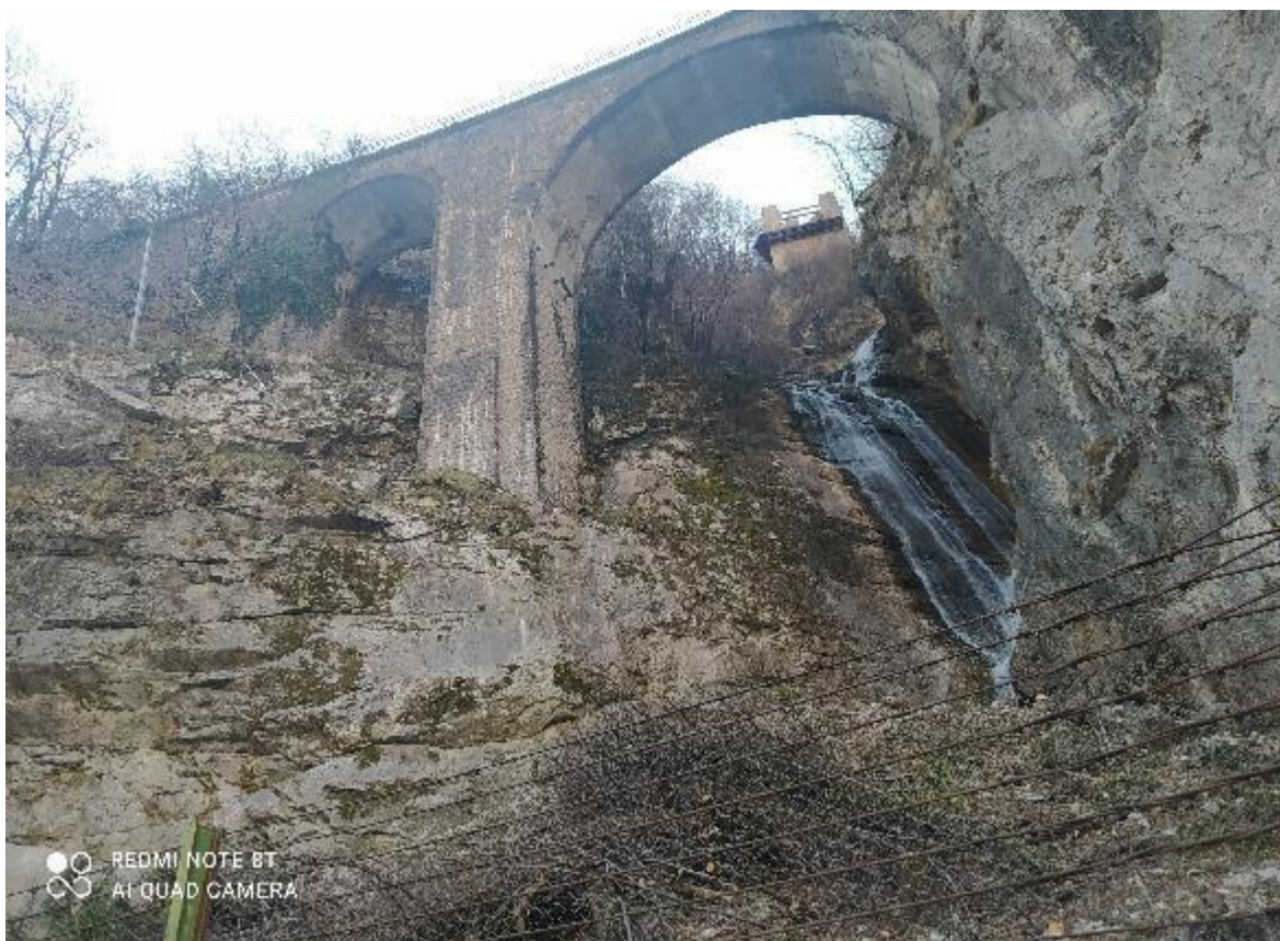
Fig. 26 - Sbocco del canalone in corrispondenza del Ponte Canale ENEL. Vista dalla SS51 del ponte ferroviario; sullo sfondo la centrale ENEL. In primo piano la rete paramassi a protezione della strada.
