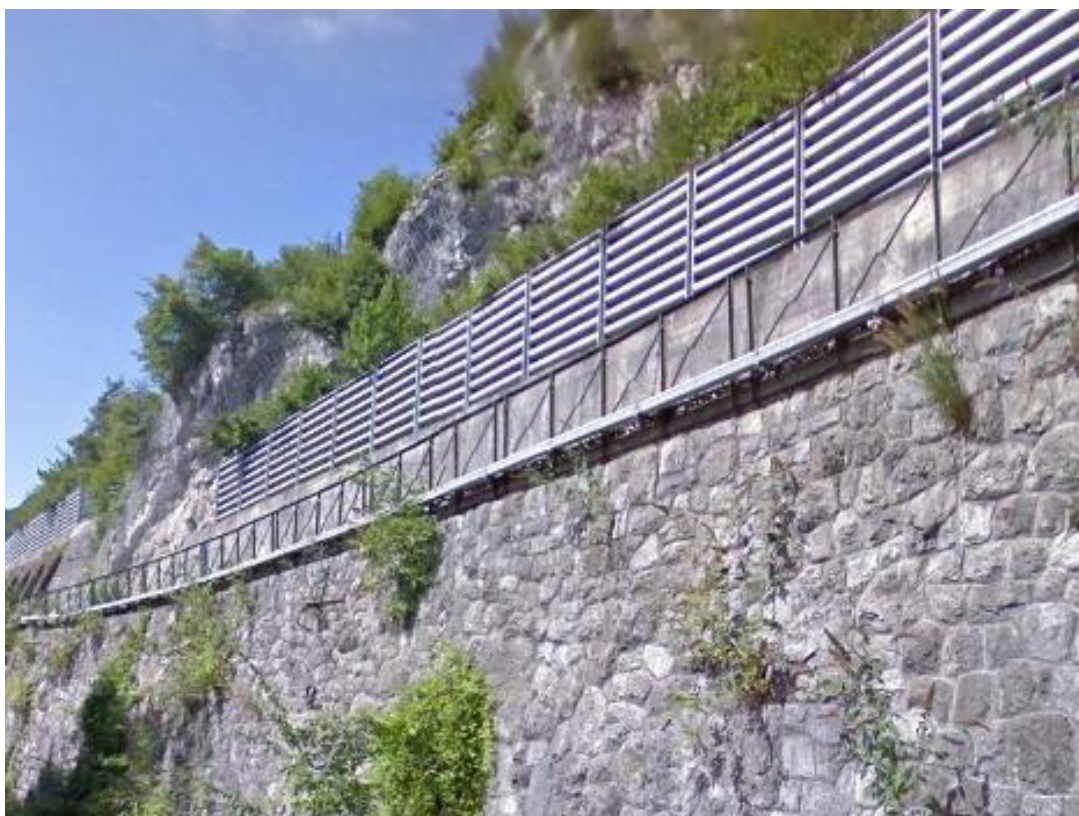
Barriera paramassi a protezione del tracciato ferroviario (vista da pista sotto linea FFSS)
