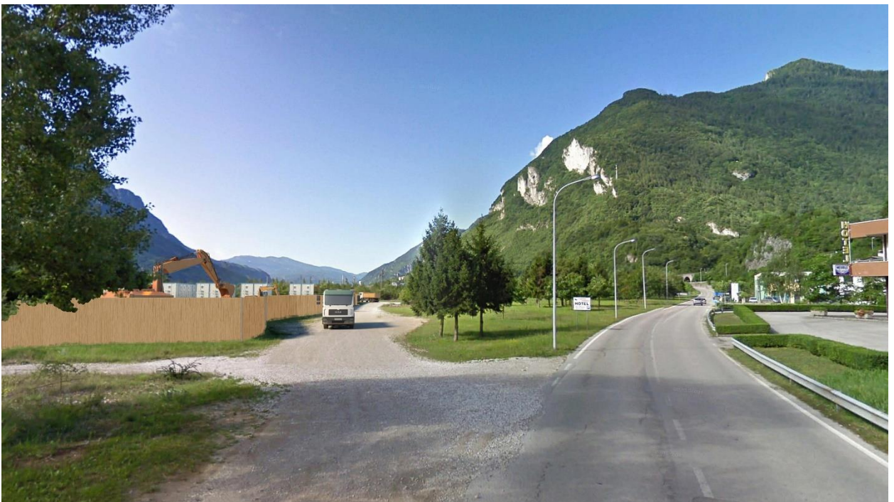
Figura 1-32 Recinzione di cantiere con pannelli di legno
