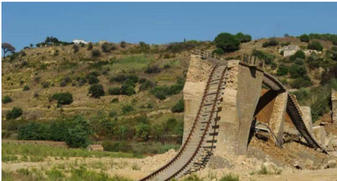
Figura 1-1 Immagine del tratto della linea Caltagirone Gela dove si è verificato il cedimento
