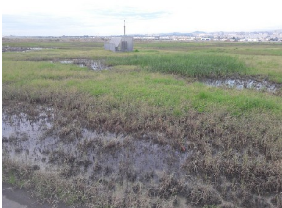
Figura 2.3: ristagni idrici lungo la perimetrale lato opposto all'aerostazione (sopralluogo dicembre 2021)
