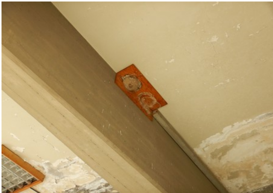
Figura 4.6: Nidi abbandonati presenti all'interno della vecchia aerostazione (Aprile 2021)
