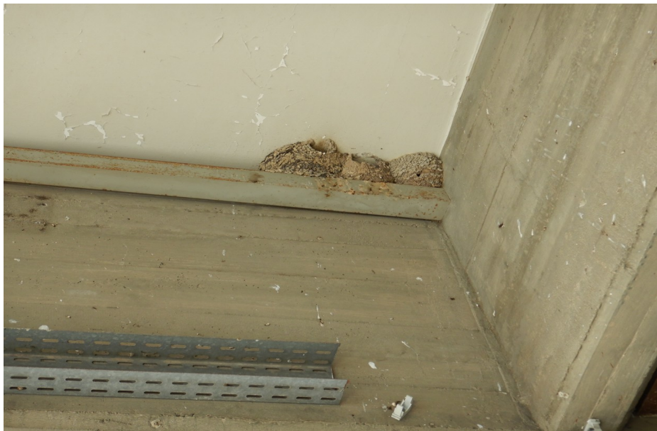
Figura 4.4: Nidi di balestrucci all'interno della caserma dei vigili del fuoco (sopralluogo aprile 2021)
