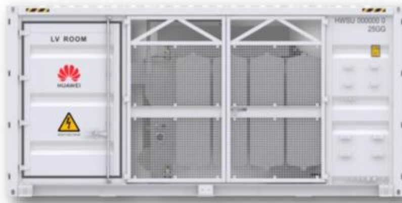
Figura 4 - Cabine di trasformazione
