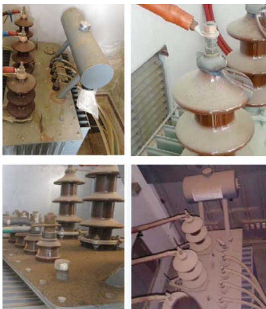
Figura 4.6: Condizioni di pulizia degli isolatori
