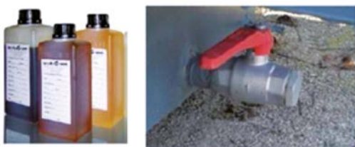
Figura 4.2: Prelievo di campioni di olio dal trasformatore
