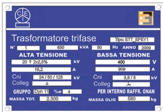
Figura 4.1: Targa di un trasformatore
