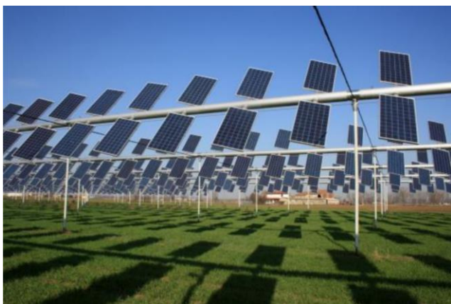
Figura 25: rete di cavi di acciaio che connette i pannelli fotovoltaici.
