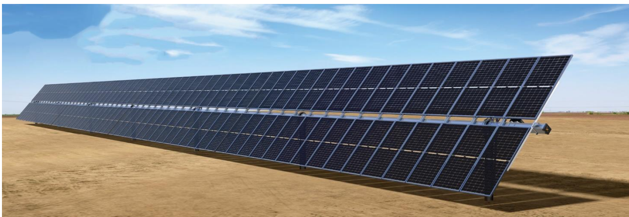
Figura 15: trackers tipo con pannelli installati.
