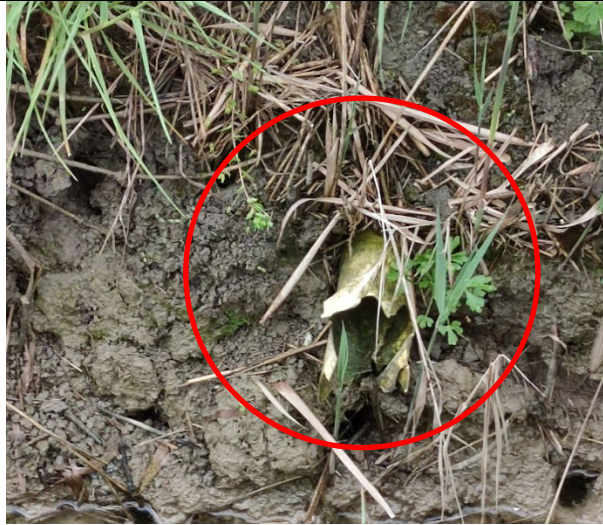
Figura 8: Sbocco delle tubazioni interrate (DN=7 cm) sui canali principali di drenaggio in terra.
