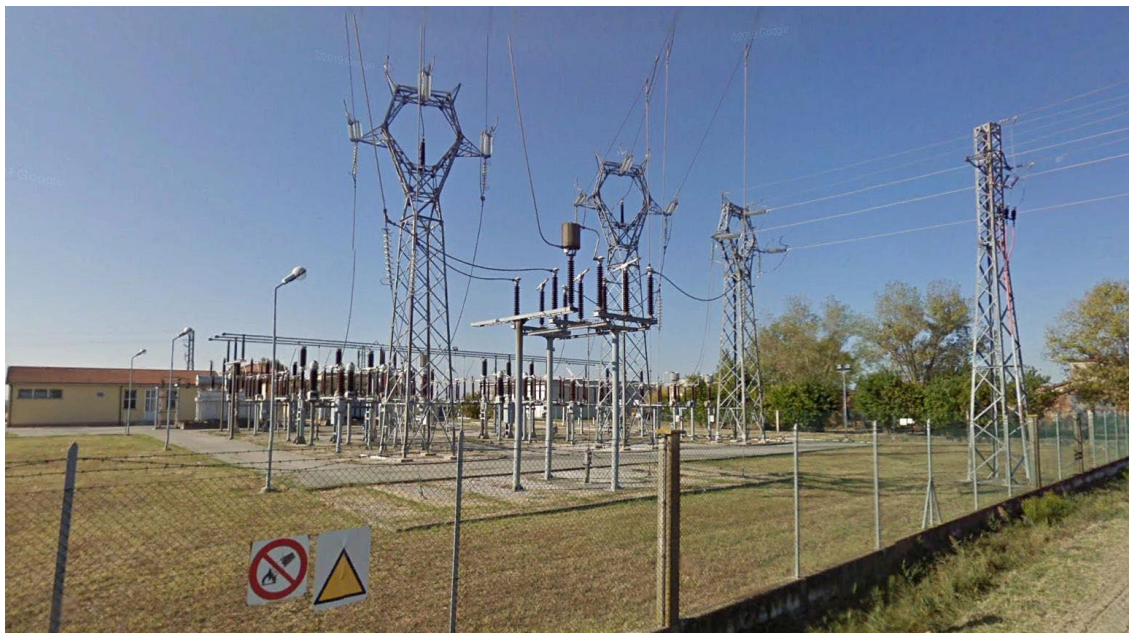
Figura 12 – Cabina Primaria “Schiappa” 150/15 kV.
