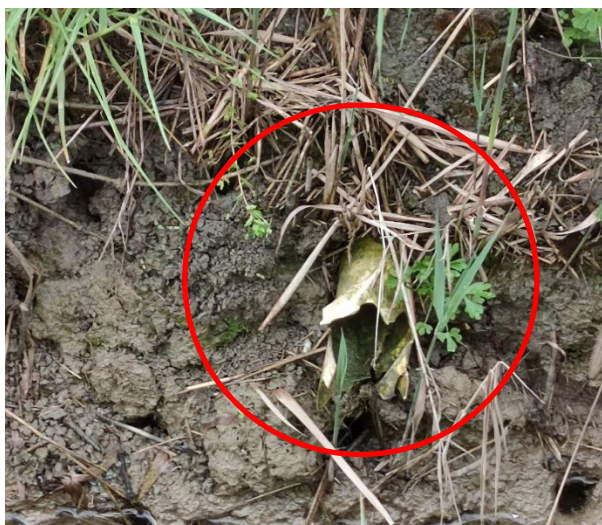
Figura 10 - Sbocco delle tubazioni interrate (DN=7 cm) sui canali principali di drenaggio in terra.
