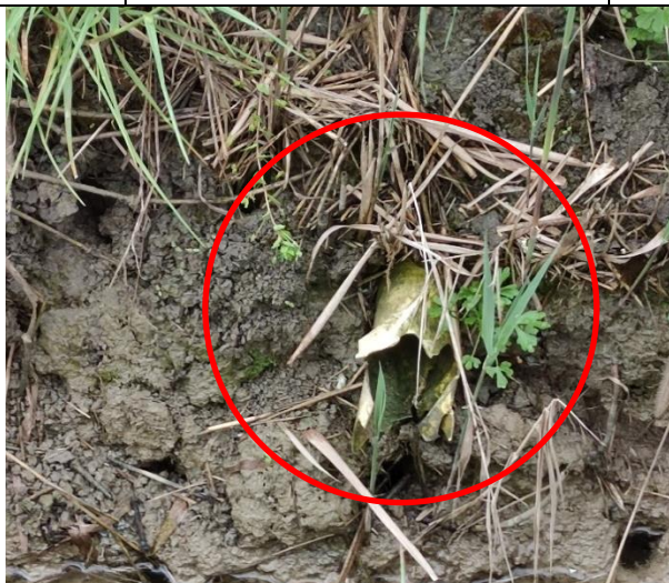
Figura 18: Sbocco delle tubazioni interrato (DN=7 cm) sui canali principali di drenaggio in terra.
