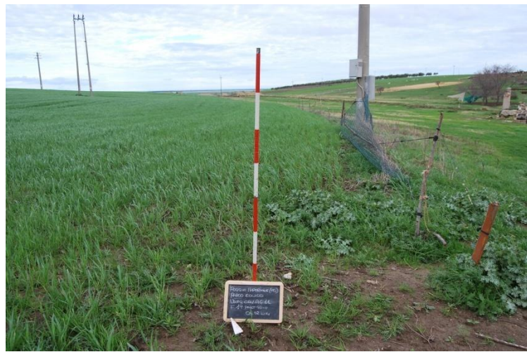
Foto 11: cavidotto di accesso all'aerogeneratore 11 visto da S (f.19 partt. lato est 95, 52R, 57; lato ovest 93, 90, 11)
