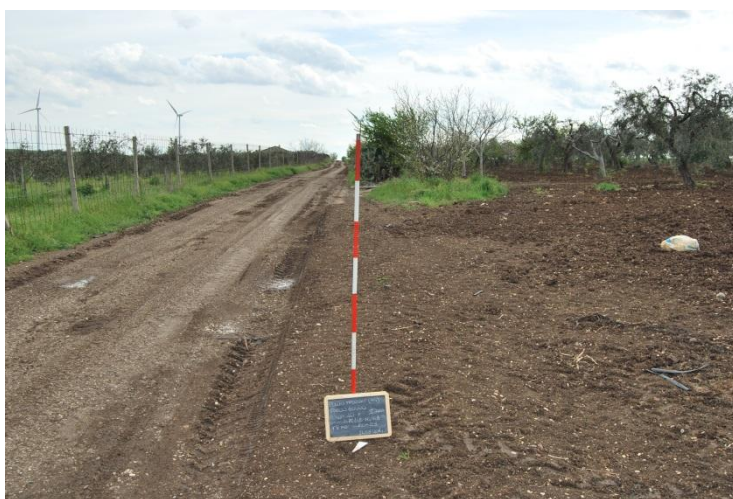
Foto 66: cavidotto di collegamento tra gli aerogeneratori 14 B e 16 B I parte, visto da NO
