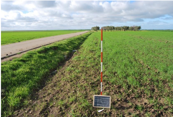
Foto 46: cavidotto di collegamento da Poggio Imperiale agli PG 8, 9, 10 visto da E/SE, IV parte (f. 12 lato nord partt. 310, 248; lato sud partt.)
