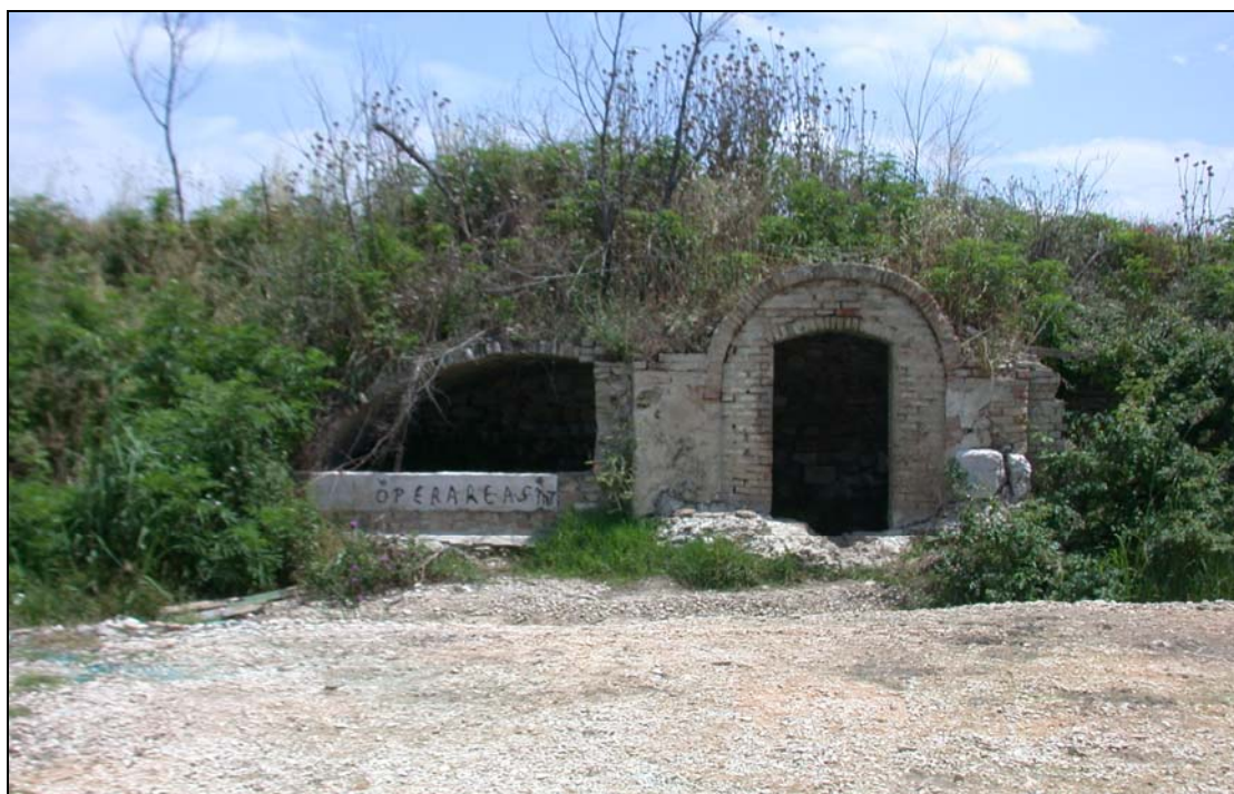
Sorgente Tre Fontane, in evidente stato di degrado
