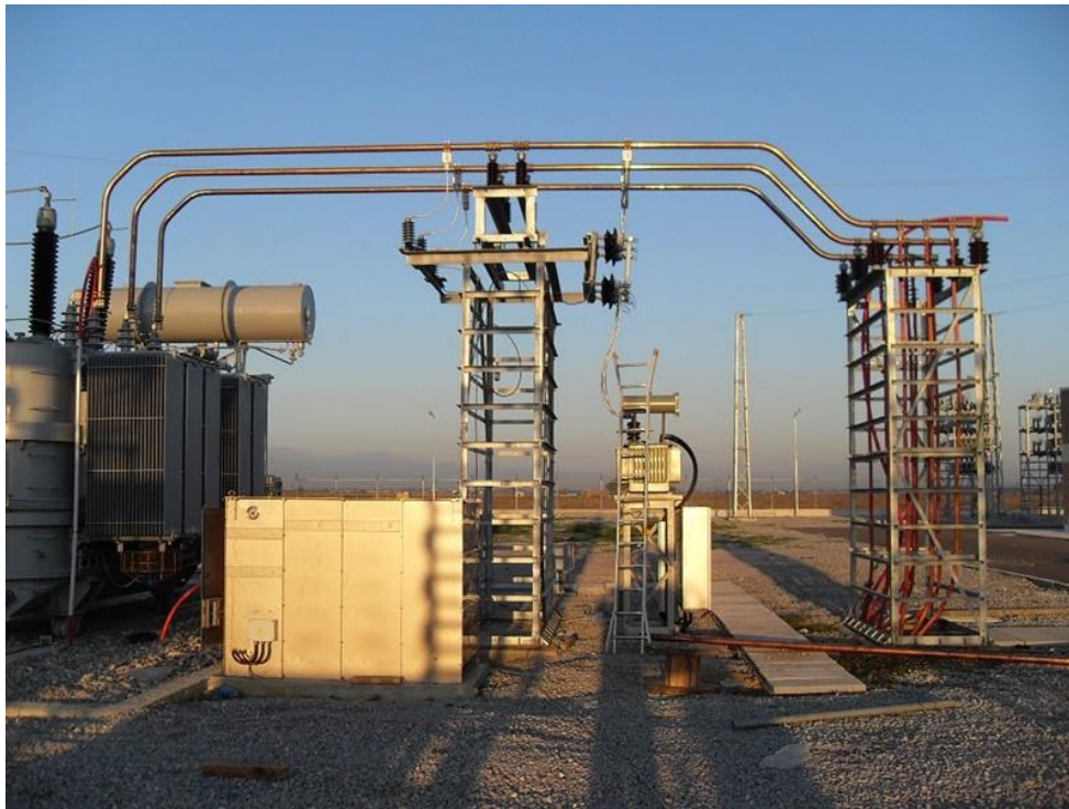
Tipico Stallo Cavi MT – Isolatori del Trafo MT/BT
