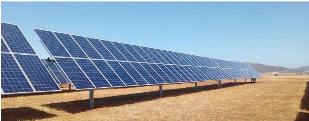
Figura 7 - Particolare del tracker in oggetto
