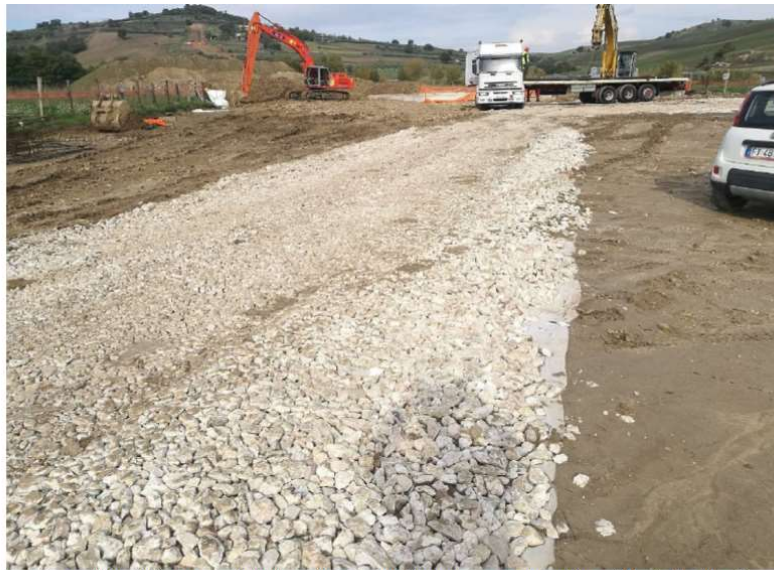
Fig. 2 – Fase di inghiaamento del piazzale ed allestimento area di cantiere “Treste” e “La Coccetta”.
