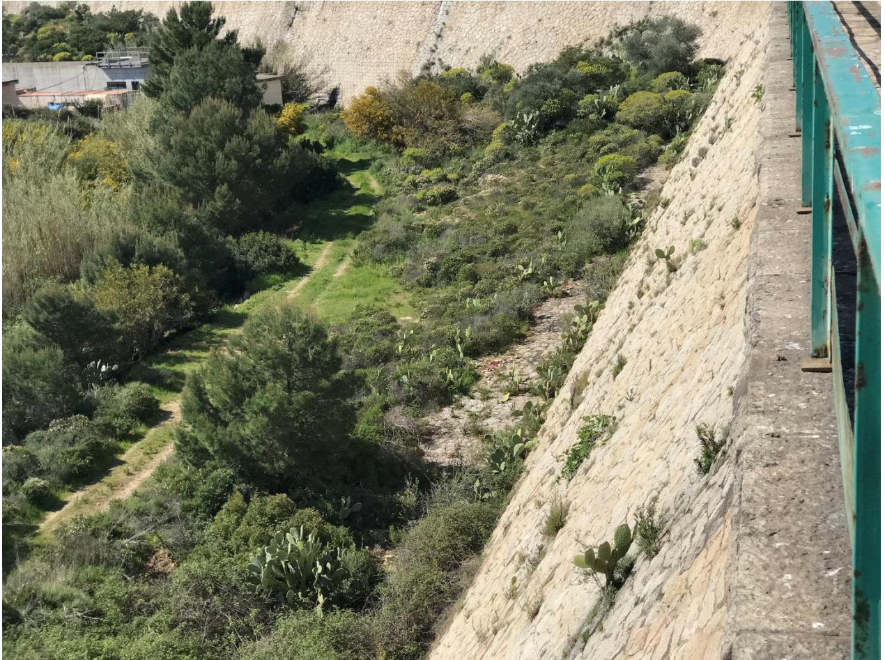
Figura 8 – Parete verticale del paramento di valle e zoccolo di fondazione parte Fosso Gambino
