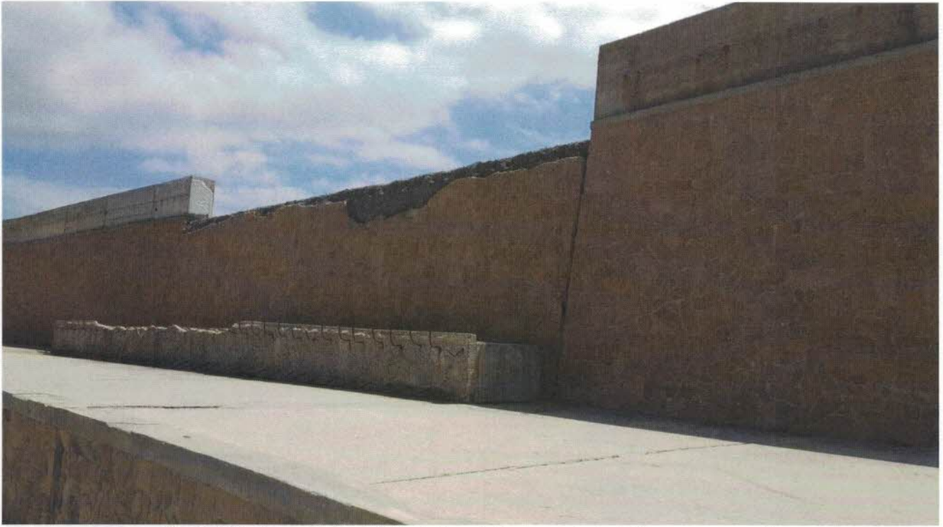
Fig. 6_ Ribaltamento parziale del cordolo sommitale del muro paraonde
