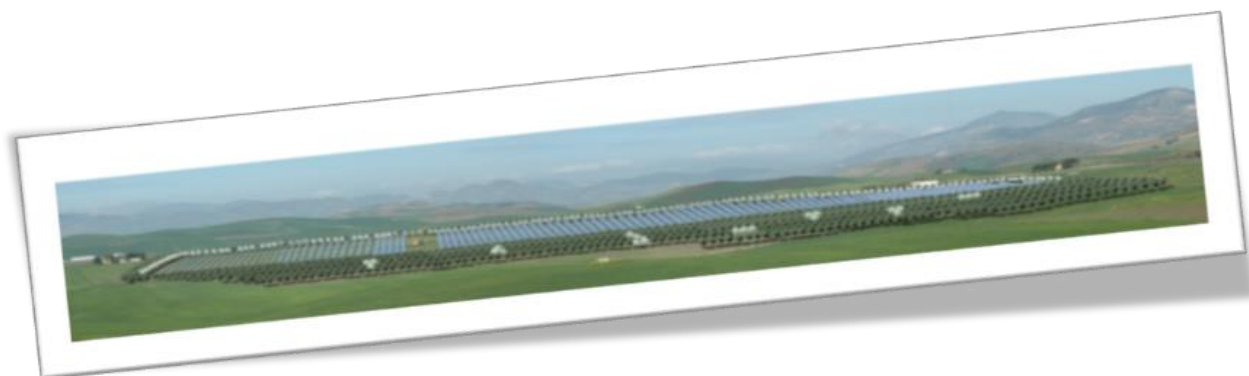
Figura 32 - Impianto fotovoltaico da 5 MW, "Heliospower", Monreale /(PA) 2010
