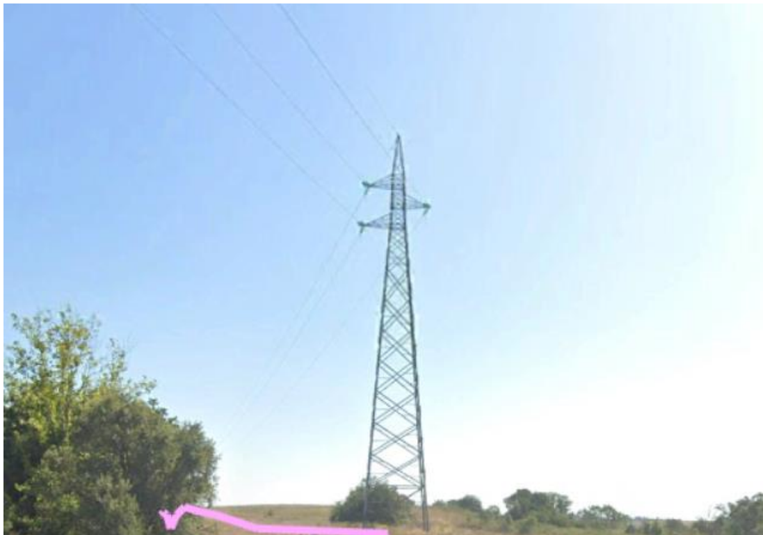
Figura 59 - Traliccio tronco piramidale linea AT da 150 kV Canino-Montalto
