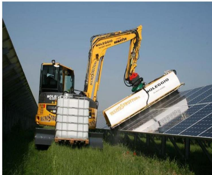
Figura 1 – Sistema automatizzato lavaggio moduli fotovoltaici
