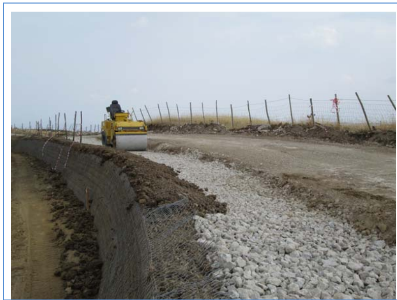
Figura 27 – Esempio di opera in terre rinforzate - Fonte HE
