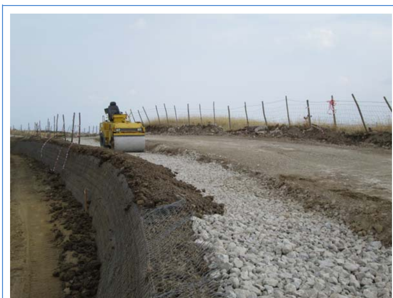
Figura 47 – Esempio di opera in terre rinforzate - Fonte HE
