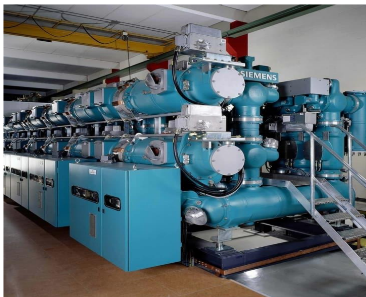
Figura 17 - Celle AT 380kV in stazione Off-shore (fonte Siemens)
