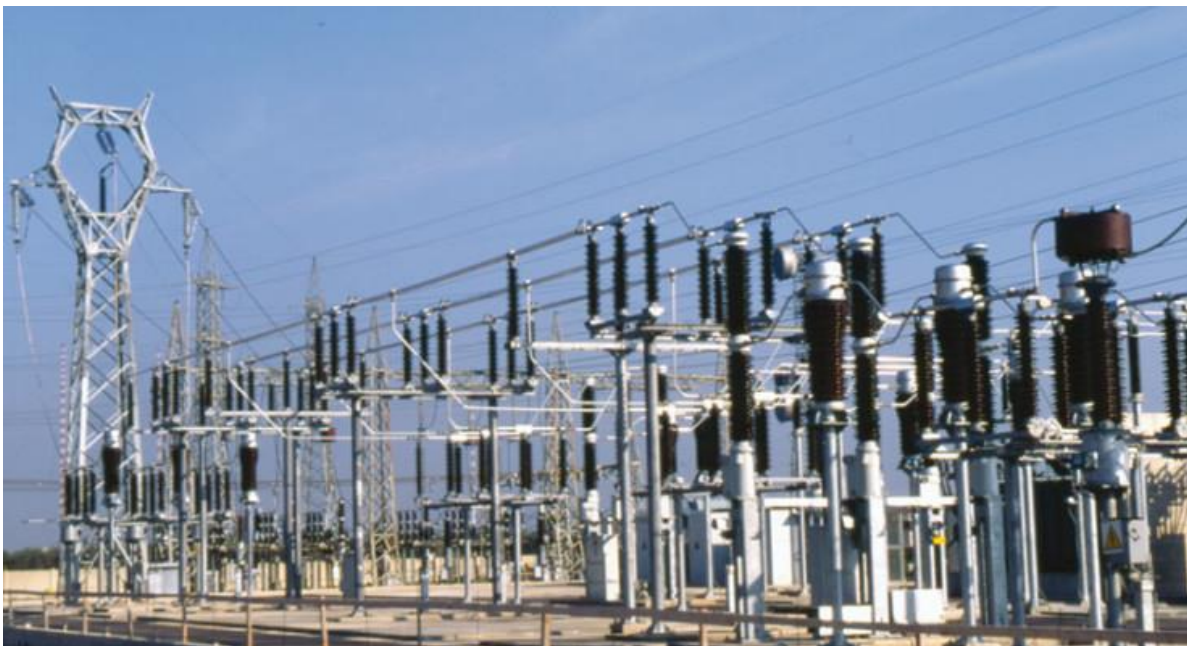
Figura 2.36 - Esempio di aspetto di stazione AT – RTN, (Fonte Web, free license)
