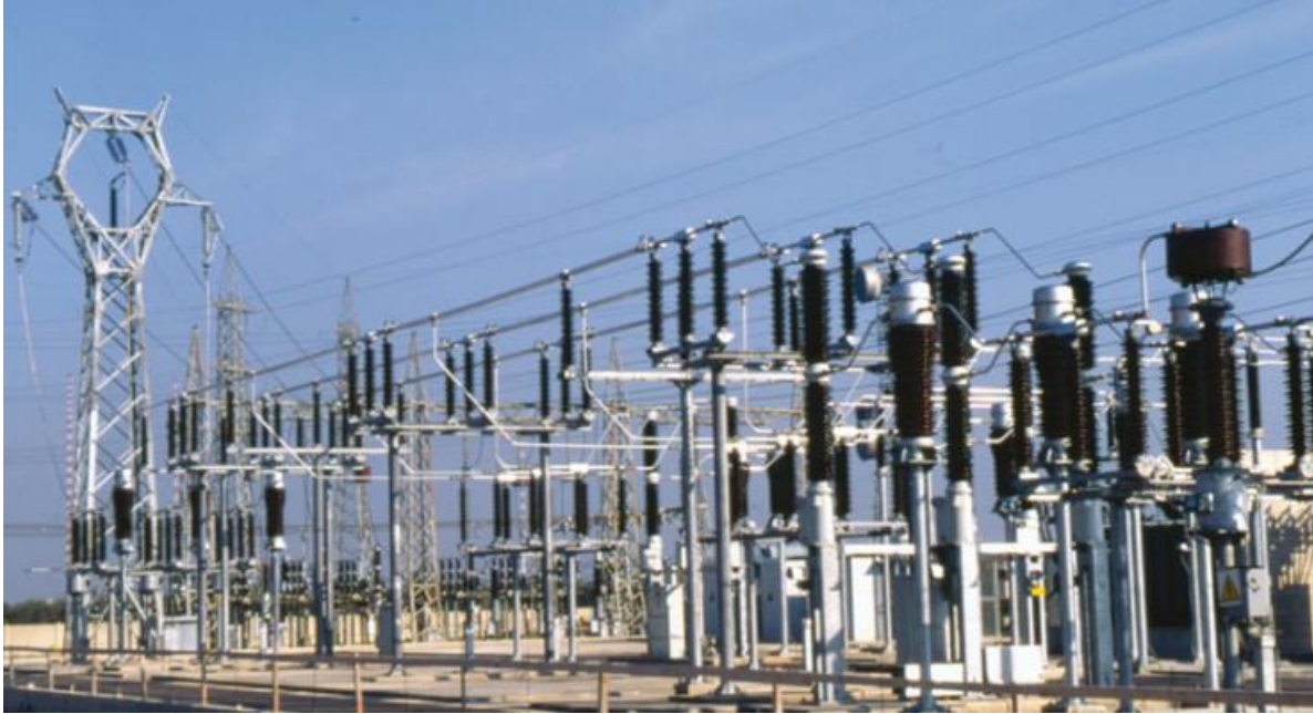
Figura 6-12 – Esempio di aspetto di stazione AT – RTN, (fonte Web, free license)
