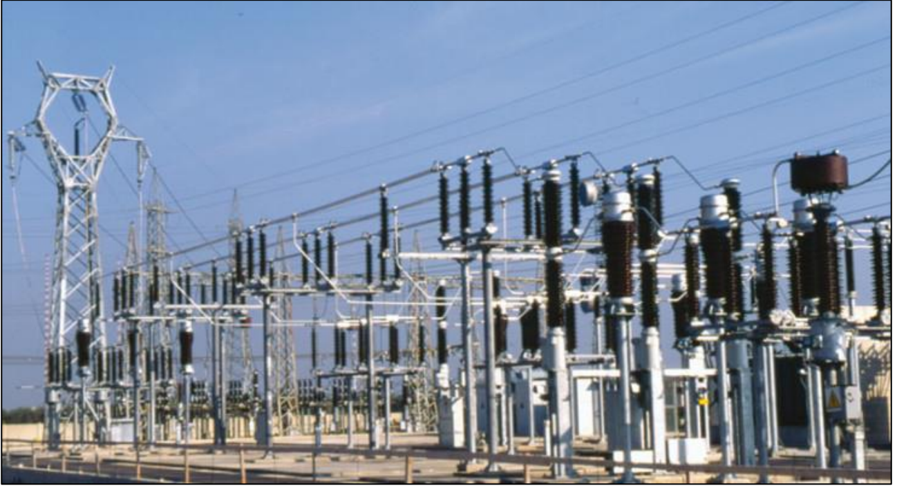
Figura 2-34 – Esempio di aspetto di stazione AT – RTN, (fonte Web, free license)
