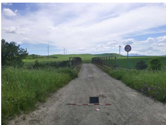
Fig. 61. CVD di collegamento tra i campi FV 1, 2e 3 e la S.E. Terna, visto da NO.
