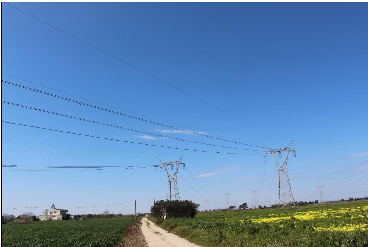
Fig. 22: zoom cavo alta tensione
