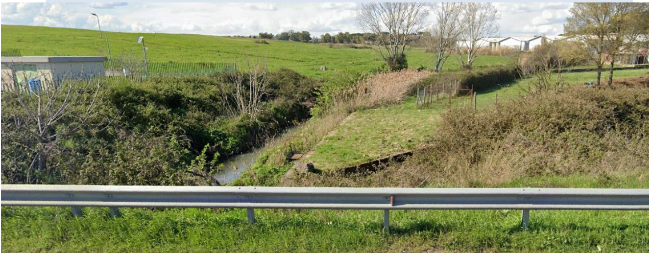
Figura 5-17 Vista del fosso della Casaccia, dalla SP493 a sud del Centro Ricerche ENEA Casaccia
