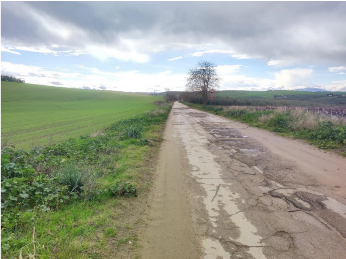
Figura 17 - Punto di Presa 5b - Regio Tratturello Canosa Monteserico Palmira - Stato di Fatto
