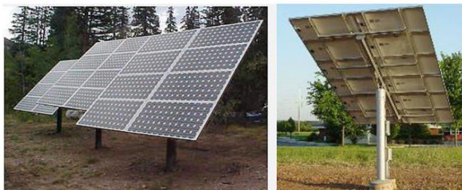
Figura 3.1-2 Inseguitori di Tilt
