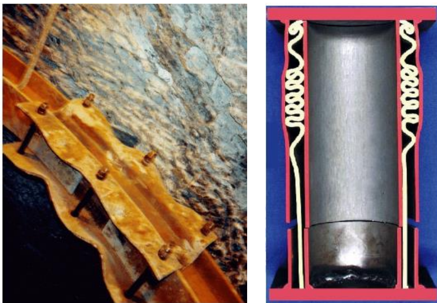
Figura 5-18 – Due diverse tipologie di giunti a scorrimento controllato impiegati nelle gallerie in condizioni spingenti
