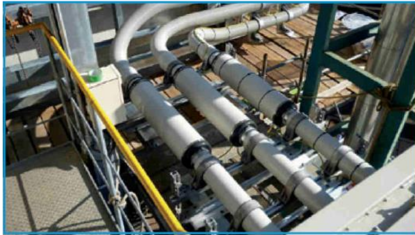
Figura 3.18: Esempio di installazione Sistema IPB (Isolated Phase Bus) – fonte: Duresca ® Bus bar system (Moser Glaser)
