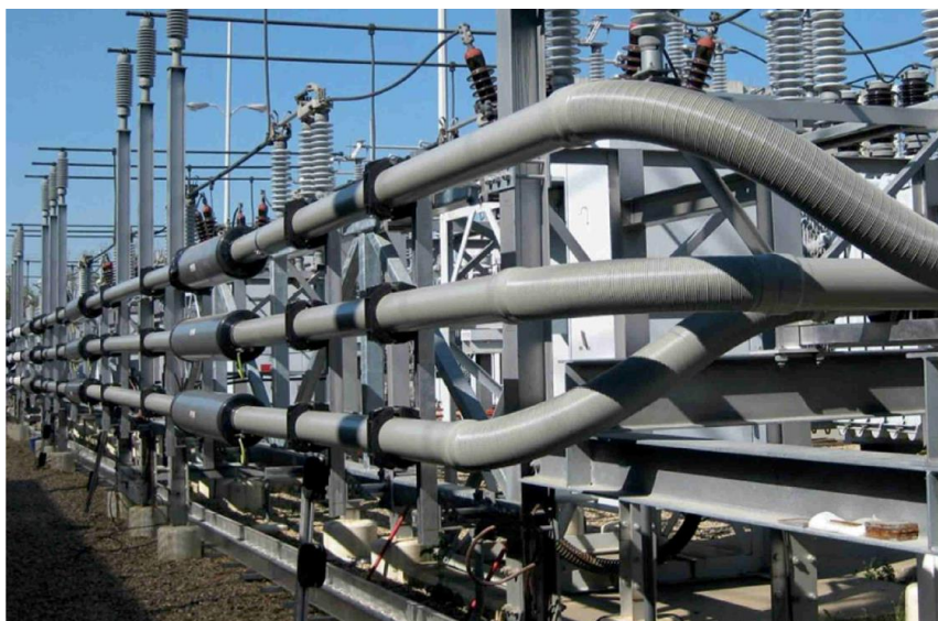
Figura 3.19: Esempio di installazione Sistema IPB (Isolated Phase Bus) – fonte: Duresca ® Bus bar system (Moser Glaser)
