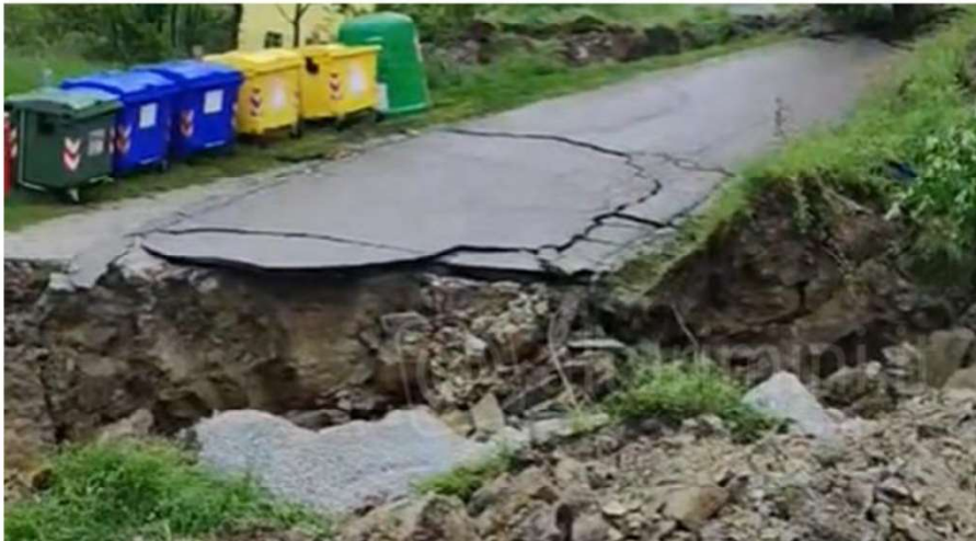
Figura 11 – Immagine di dissesto a causa dell'alluvione del Maggio 2023 che ha colpito la Romagna
