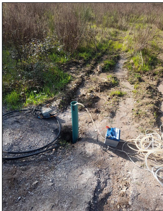
Monitoraggio acque sotterranee
