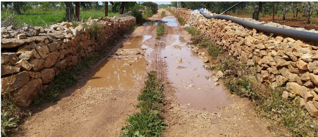
Viabilità esistente con pavimentazione naturale in pessimo stato
