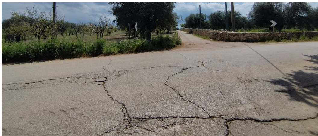
Viabilità in conglomerato bituminoso esistente in pessimo stato
