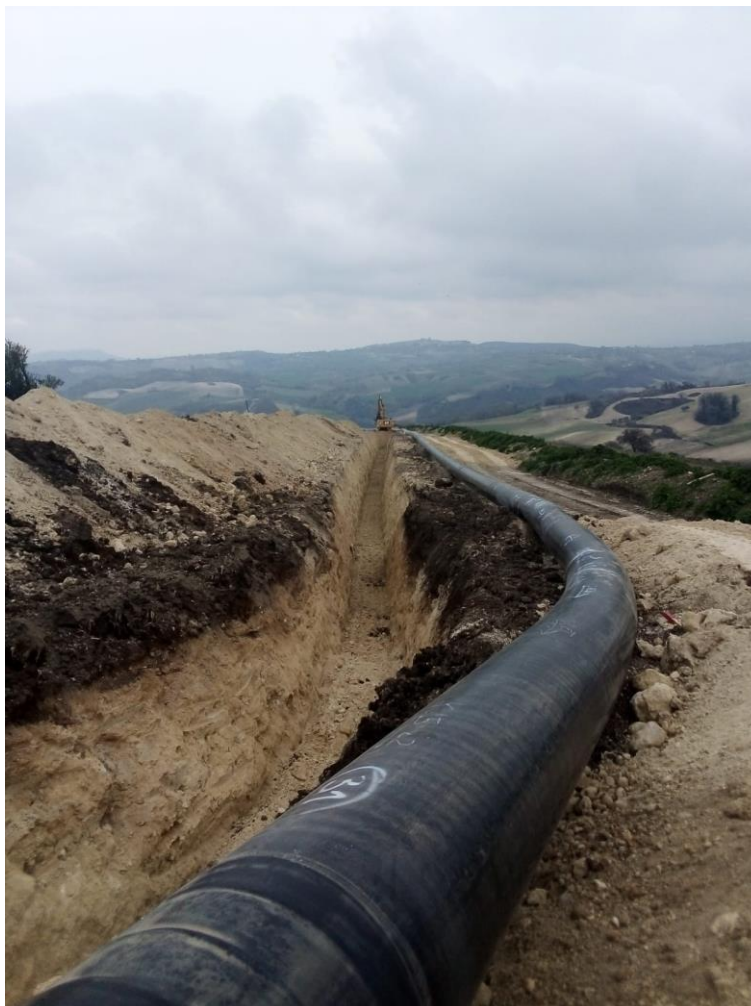
Fig. 2 – Scavo della trincea – separazione tra terreno scavato (a destra) e l'humus precedentemente accantonato (a sinistra)
