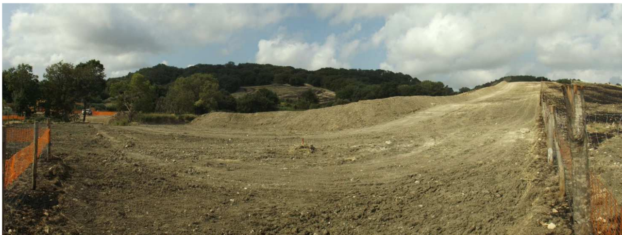
Figura 3.4 – Delimitazione della pista di lavoro e scotico dell’humus nel tratto relativo al punto di monitoraggio SUP02MN.
