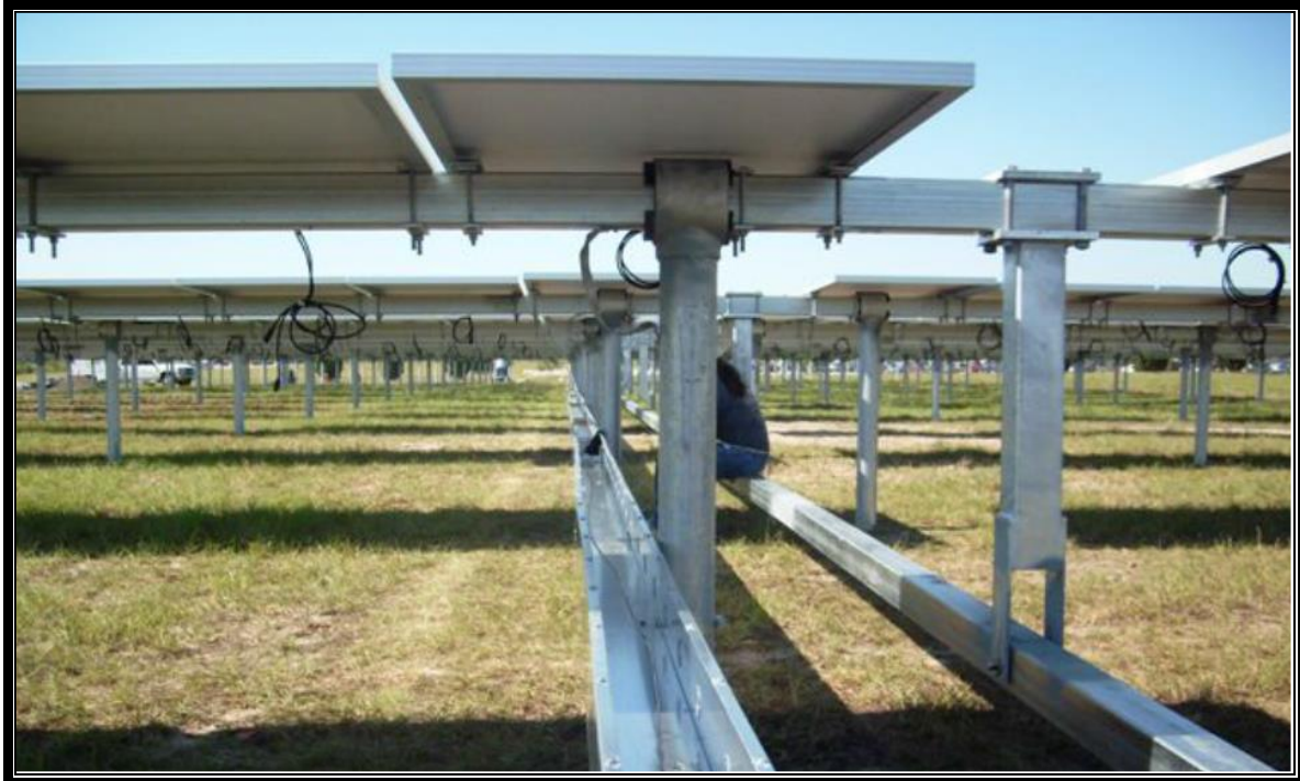
Figura 57 - VISTA DELLE STRUTTURE AD INSEGUIMENTO MONOASSIALE
